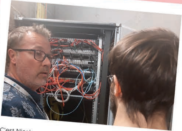
C'est Nicolas cette fois l'homme de la situation ! Il intervient sur un de nos "switches" pour "patcher" les ordinateurs de la lingerie, en d'autres termes, les relier au réseau . Ils sont deux au service informatique à s'occuper de l'infrastructure réseau : Nicolas donc et Charles.
